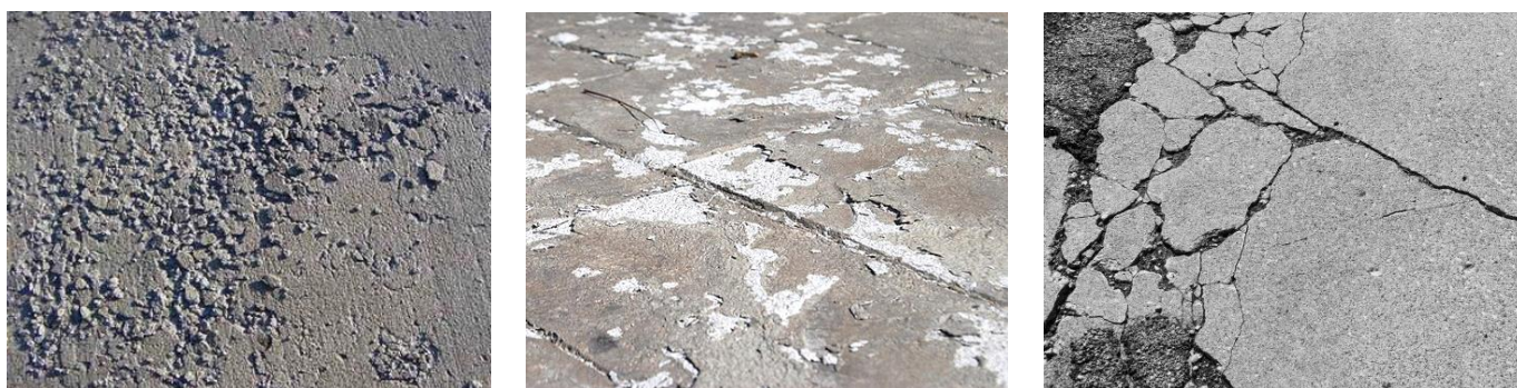
شکل ۱. فرسایش و زوال سطح رویه بتن [۲ و ۱]
