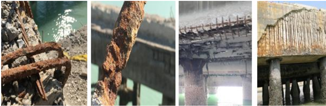
شکل ۲. نمایی از تخریب اسکله PI بندر امام و خوردگی آرماتور در بتن
