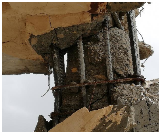
ث) تخریب کامل بالای ستون و چشمه اتصال e. Complete destruction of concrete core and joint at top of the column
