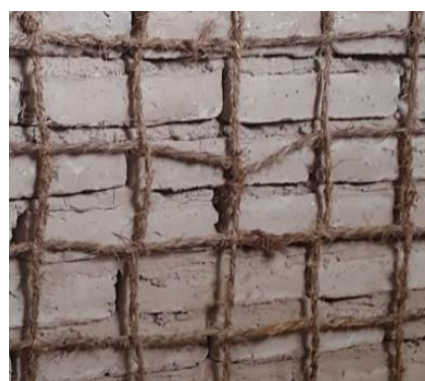
شکل ۴. نحوه ی مهار مش با طناب الیاف خرما Fig. 4. Lateral restraint of palm meshes with palm tie
