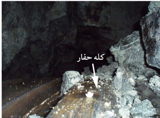
(ب) فضای خالی در اطراف کله حفار و ریزش مصالح بر روی آن
